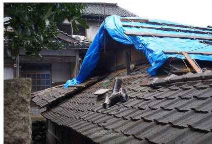
↑気高町姫路地区の被災状況
